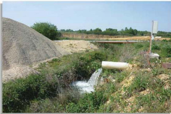
Rejet dans le réseau superficiel
