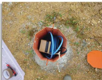
Equipement d'ouvrages avec des stations automatiques de mesures du niveau d'eau
